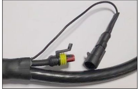
Fig: Conector de pareamento desconectado
